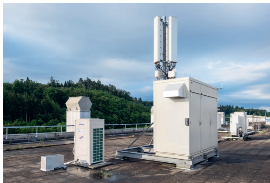
Beim neu installierten Antennen-System befinden sich die abgesetzten Radioeinheiten direkt am Antennenmast. So werden sie direkt durch die Aussenluft gekühlt, was die Wärmelast und daher die erforderliche Kühlleistung innerhalb der Basisstation reduziert.
