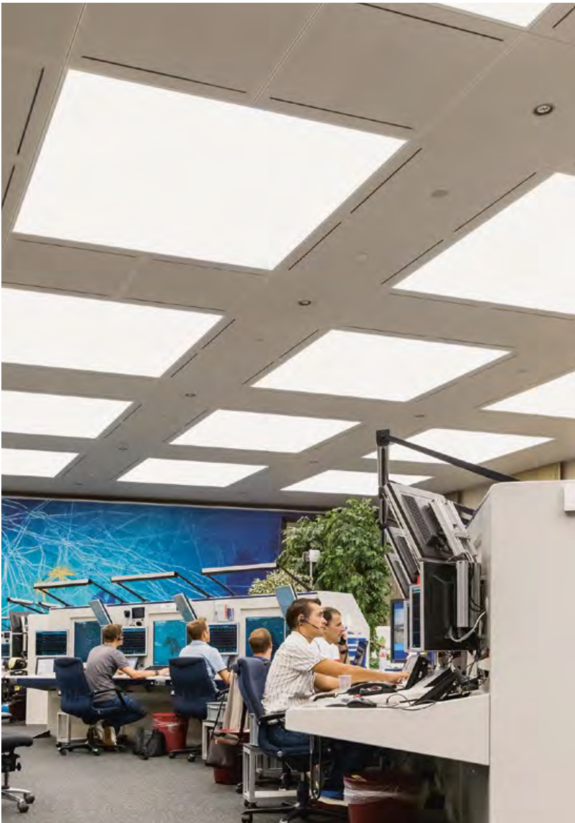
Illuminazione dal soffitto nel centro di controllo di Wangen
